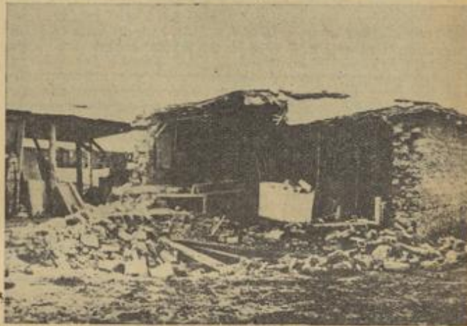
Erste Originalaufnahme von dem furchtbaren Erdbeben in der Türkei. Ein völlig zerstörtes Wohnhaus in einem Vorort von Erzincan (2).
