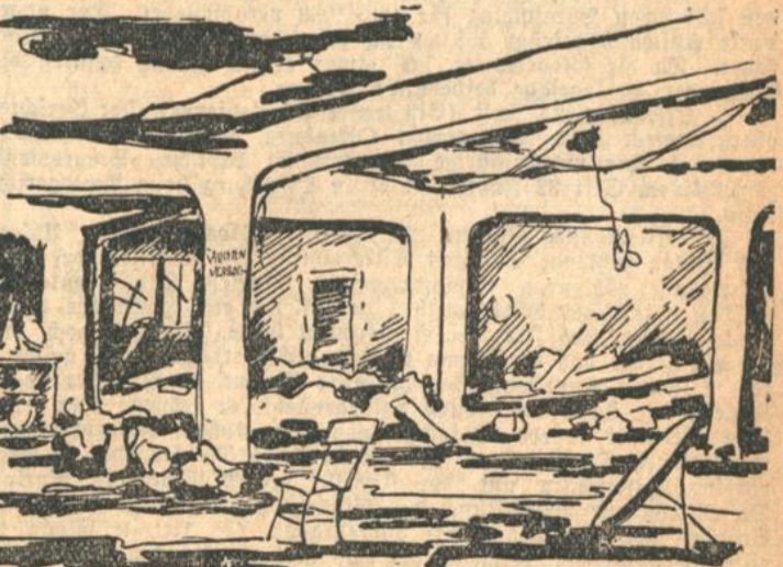
Das ausgebrannte 3. Stockwerk.
