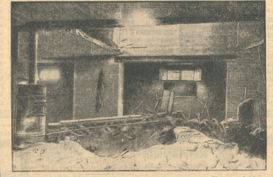
Der Keller des Neubaus in Berlin-Weissensee, in dem sich der schwere Einsturz ereignete. Auf dem Hüfnerbau für die Angestellten des Stadtkonzepts in Berlin-Weissensee stürzte die mit Zementblöcken überlastete Stelldede ein und begrub sämtliche Bauarbeiter unter sich.
