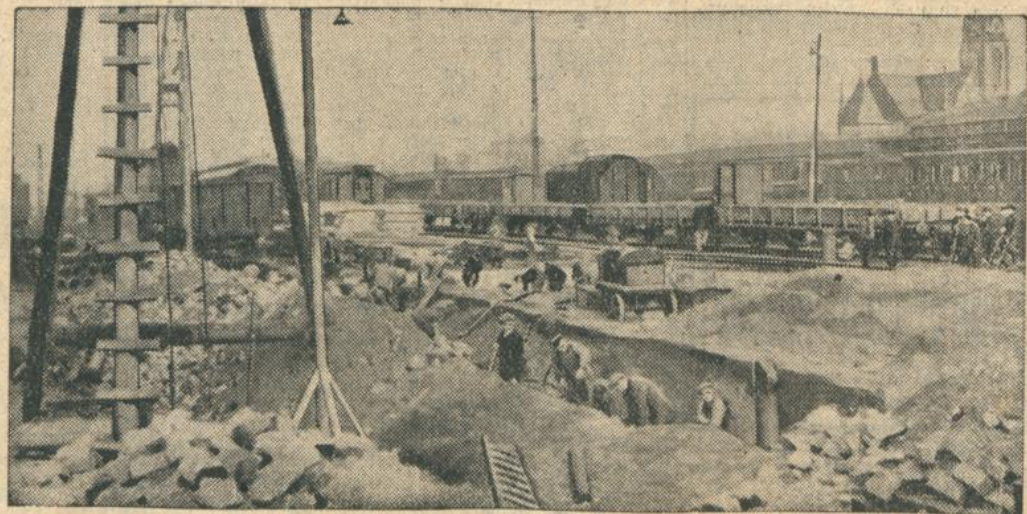
In Berlin wurden jetzt mit aller Kraft die Arbeiten an dem Verbindungstunnel mit Untergrundbahn zwischen dem Steintor und dem Anhalter Bahnhof in Angriff genommen, der auch die Verbindung mit der von Osten nach Westen Berlin durchquerenden Stadtbahn schafft. Dieser Tunnel wird für alle Reisenden, die die Großstadt berühren und auf einem anderen Bahnhof weiterfahren müssen, eine große Verkehrsvereinfachung bringen und gleichzeitig die überfüllte Innenstadt entlasten.
