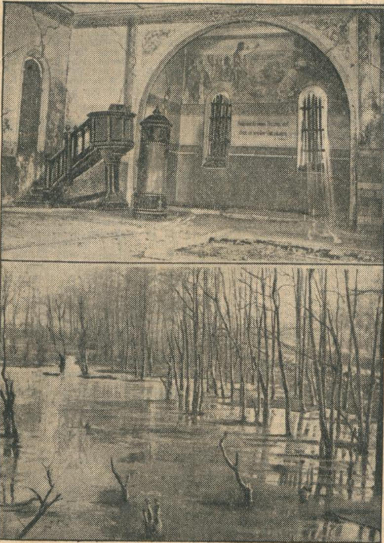
Oben: Die Kirche von Schnappach, die polizeilich gesperrt werden mußte, da sie infolge Bodenentkunst einzustürzen droht.
