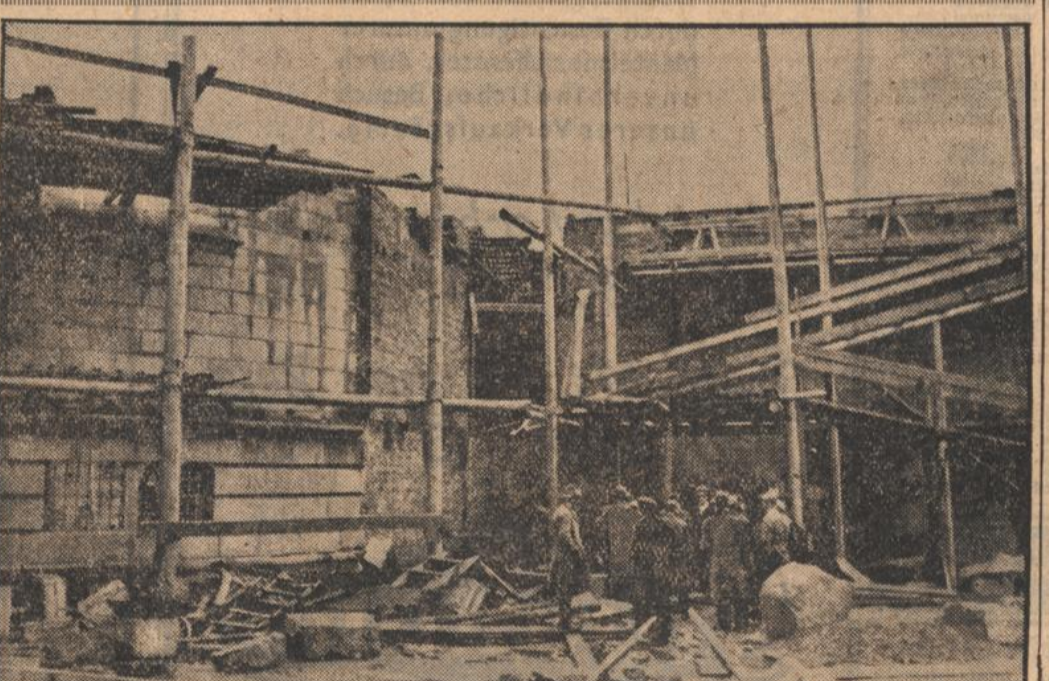
Das Einsturzunfall beim Neubau der Rattowitzer Kathedrale. Am Neubau der Kathedrale in Rattowit brach, wie gemeldet, ein Teil des Bauwerkstoffes mit 70 Ar-beitern zusammen. 60 von ihnen wurden verletzt, davon 30 schwer.
