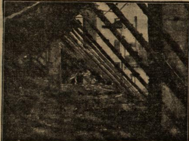
Der total ausgebrannte Dachstuhl
