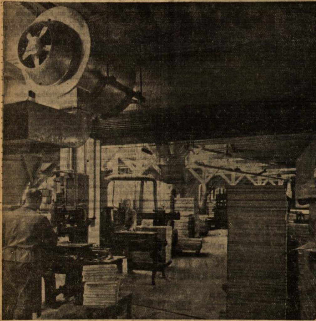
Eine neuzeitliche Entstaubungsanlage
