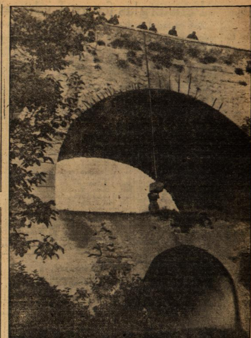
Anderthalb Tonnen Sprengstoff werden in die Pfeiler der Fahrbahn dieser in Süditalien gelegenen Brücke eingebaut — eine Menge, die ausreichen dürfte, um dieses Bauwerk in Atome zu zersplittern und dadurch die Feindoperationen empfindlich zu stören. (PK-Aufnahme: Meister (HH))
