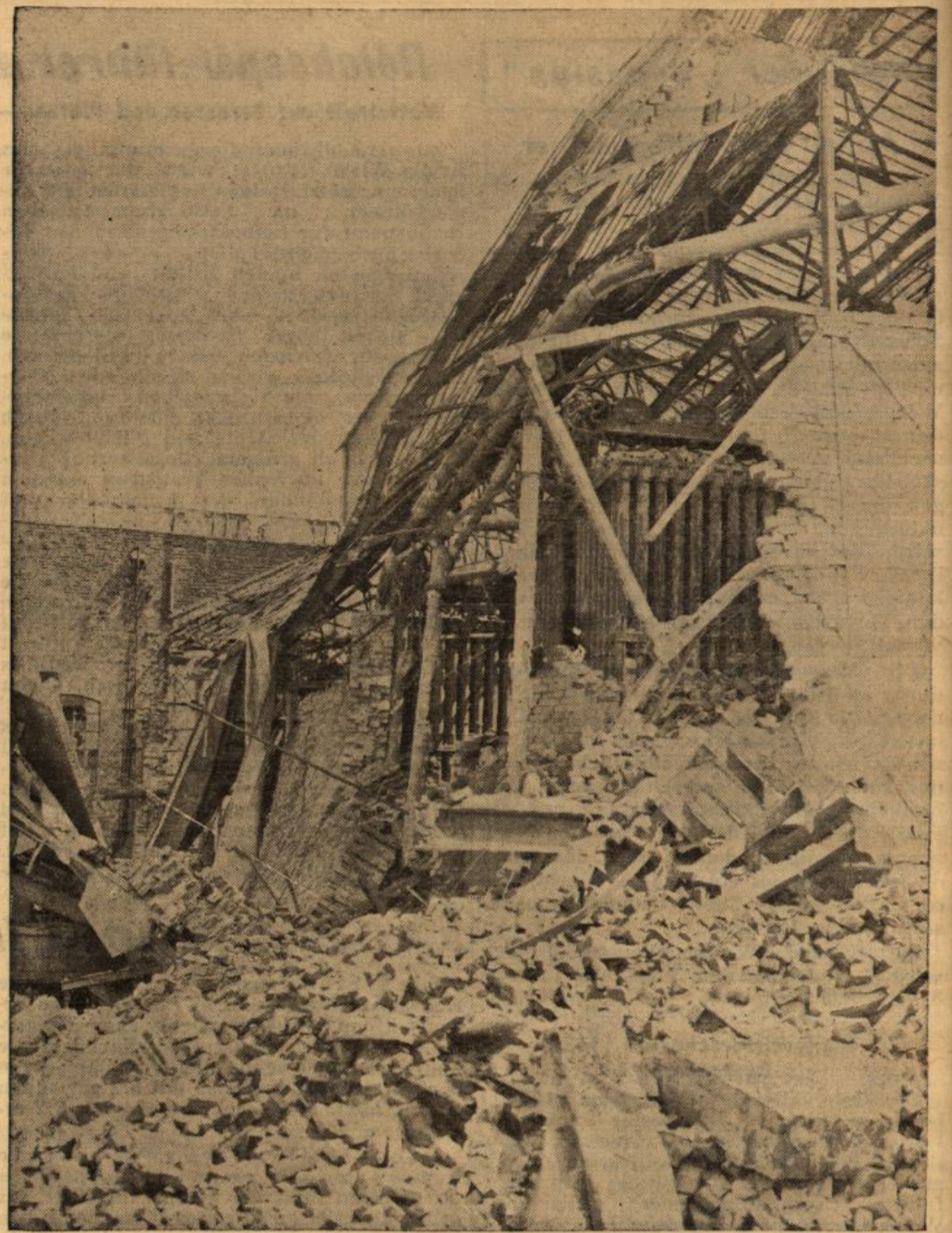
Das haben die Franzosen hinterlassen: Trümmerhaufen, Verwüstungen, Ruinen. Kein Stein ist hier auf dem andern geblieben. Die Zerstörer haben ganze Arbeit geleistet.
