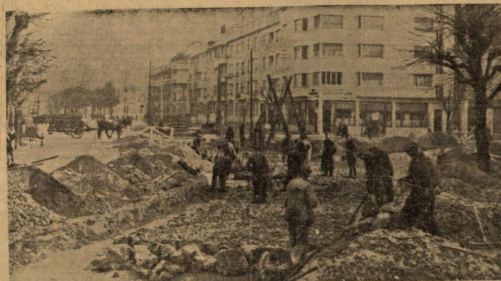
In der Gerstheimer-Straße in Strassburg-Neudorf wird ein neuer Gleisanschluss für die Straßenbahn gelegt, um die Umleitung der Linien 1 und 4/14 zu ermöglichen. Aufnahme: Amann
