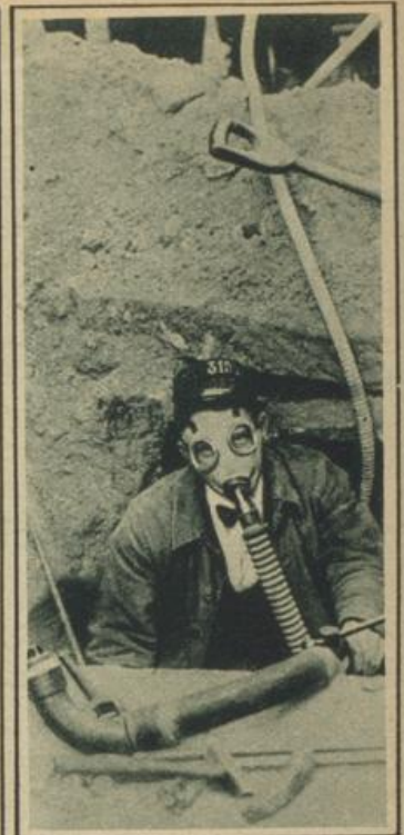
Eine neue hygienische Einrichtung bei den Amsterdamer Gasarbeitern. Arbeiter untersucht mit Gasmaske geschützt einen Rohrbruch Frankl
