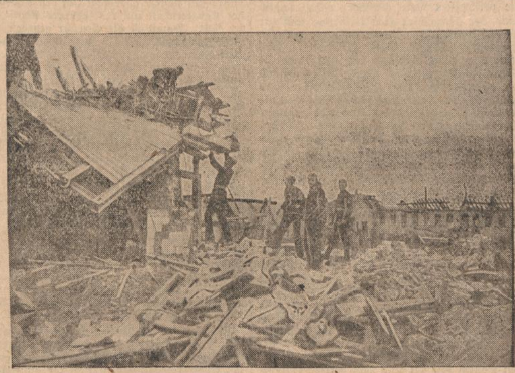
Bergungsarbeiten. Feuerwehrleute suchen nach den Toten und Verletzten, die unter den Schuttmassen begraben liegen.
