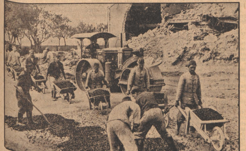
Nach dem Waffenstillstand Wiederbau in Frankreich Unter Bild zeigt Männer der Organisation Dr. Todt, die in Frankreich Zerstörungen beseitigen und Straßen ausbessern. (Hilfswörter: Bred, Jander-M.)
