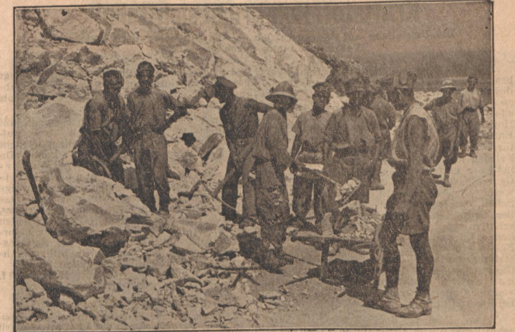
Neue Verkehrswege in Nordafrika. Die Straßen im nordafrikanischen Kampfgebiet sind überaus wichtig für die Versorgung der Front. Hier sind italienische Straßenbauarbeiter trotz großer Hitze unermüdet dabei, die große Wüstenstraße an der Küste entlang zu verbessern und zu verbreitern. (PK-Mühlbrandt, Scherl-M.)
