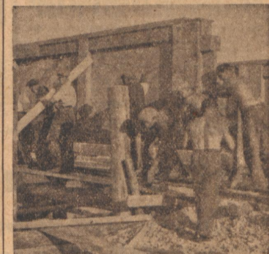
Der Aufbau beginnt. Unverzüglich wurden in Baden sowohl wie im Elsaß die Aufbauarbeiten mit deutscher Gründlichkeit und Schnelligkeit in Angriff genommen, um die Schäden des Krieges so schnell wie möglich zu beseitigen.
