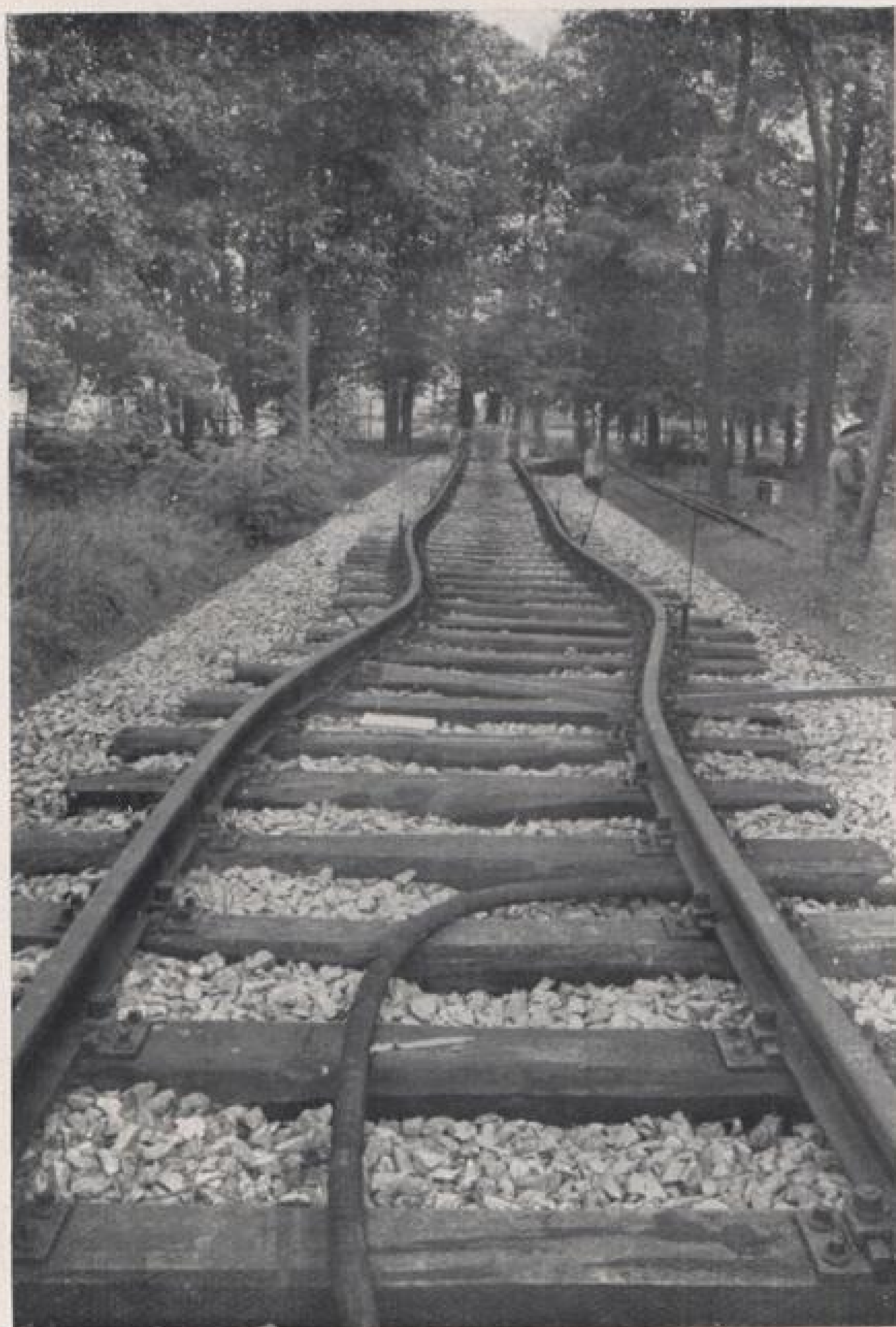
Ansicht einer künstlich erzeugten Gleiswerfung.
