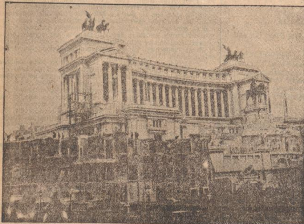
Abbrucharbeiten in Rom gegenüber dem gewaltigen Viktor-Emanuel-Denkmal. Zwischen dem Piazza Venezia und dem Kolosseum in Rom soll eine große Straße gelegt werden, die durch den Autoverkehr dringend nötig geworden ist.
