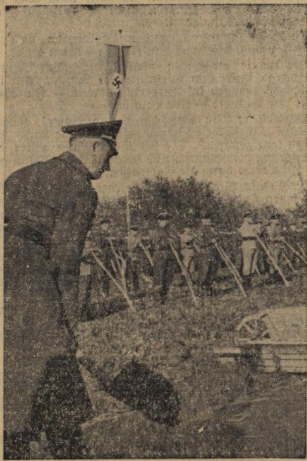
Die Eröffnung der Arbeiten zur Pfingz- und Saalbachkorrektion. Erster Spatenstich durch den Reichsstatthalter Robert Wagner. Aufnahme: Photo Geschwindner-Karlsruhe.
