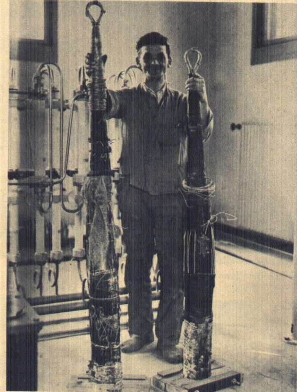
Der Mast des Großrundfunk-Senders Tegel ist vom Sendehaus fast 100 Meter entfernt. Die im Bild gezeigten riesigen Spezial-Energie-Kabel, deren Ende der Mann in der Hand hält, dienen zum Transport der Wellen-Energie vom Sendehaus bis zur Antenne.
