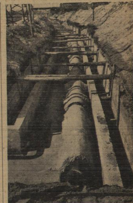
Blick auf die Dampfrohnanlage, die vom E-Werk bis zum Siemenswerk führt, zunächst, wie hier, in Betonkanälen, dann als Freileitung. Fotos: Schlesiger
