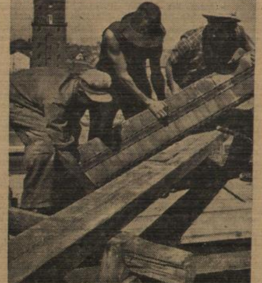
In 25 m Höhe, auf der Turmterrasse, wird das Gerüst gebaut. Hier sind Bauarbeiter damit beschäftigt, einen schweren Stein der Umfassungsmauer wegzubringen, um Platz für die Eisenträger zu schaffen, auf denen das Gerüst aufgebaut werden wird. Im Hintergrund der Rathausurm. Fotos: Schlesiger
