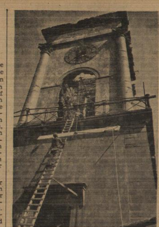
Mit Behelfsaufzügen werden die für das Gerüst benötigten Einzelteile hochgezogen. Unser Bild zeigt die obere Hälfte der Turmruine mit dem 14 m hohen Abschluß, von dem noch nicht sicher ist, ob er erhalten werden kann oder abgerissen werden muß.
