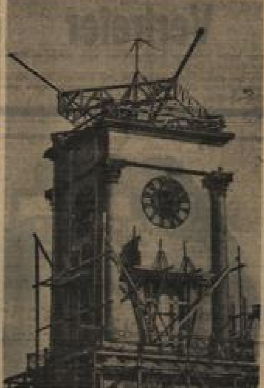
Das höchstgelegene Karlsruher „Karussell“ ist nichts weiter als eine raffinierte Hilfskonstruktion zum Bau eines Turmgerätes.
