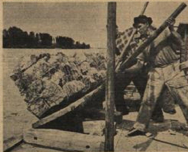
Gleich überdimensionalen Postpaketen werden hier auf dem Rhein Steine in Maschendraht gefüllt und dann zur Erhöhung der durch die Strömung zerstörten Bühnen in die Fluten gekippt.
