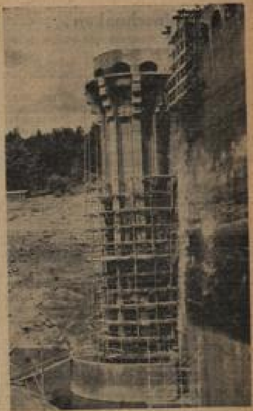
Die Reparaturarbeiten an den Schleusenmotoren der Schwanenbochlerperre gehen dem Ende entgegen. Foto: K. Eike
