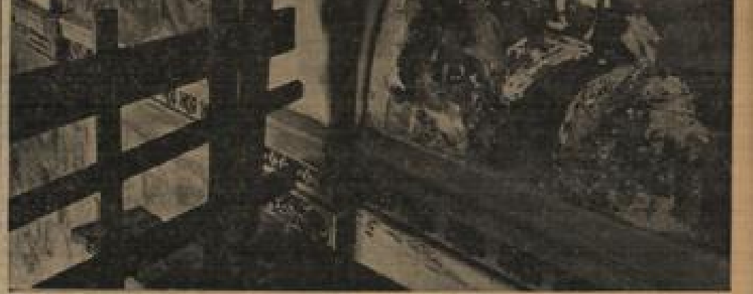
Blick von zehn Meter hohem Gerüst auf das stark beschädigte rechte Lunettenbild links in der Tiefe ist das große, bereits restaurierte Mittelbild — die Einweihung des Freiburger Münsters — zu sehen. Foto: Schlesiger
