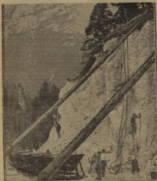
Die neue deutsche Alpenstraße im Bau. Bohrungsarbeiten an der neuen Alpenstraße, die durch die engen Felsentäler des Berchtesgäbener Landes führt.
