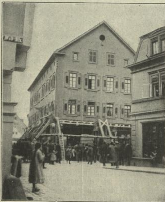
Vom Unglück in Nagold: das Wirtshaus „zum Hirschen“ während der Hebung.
