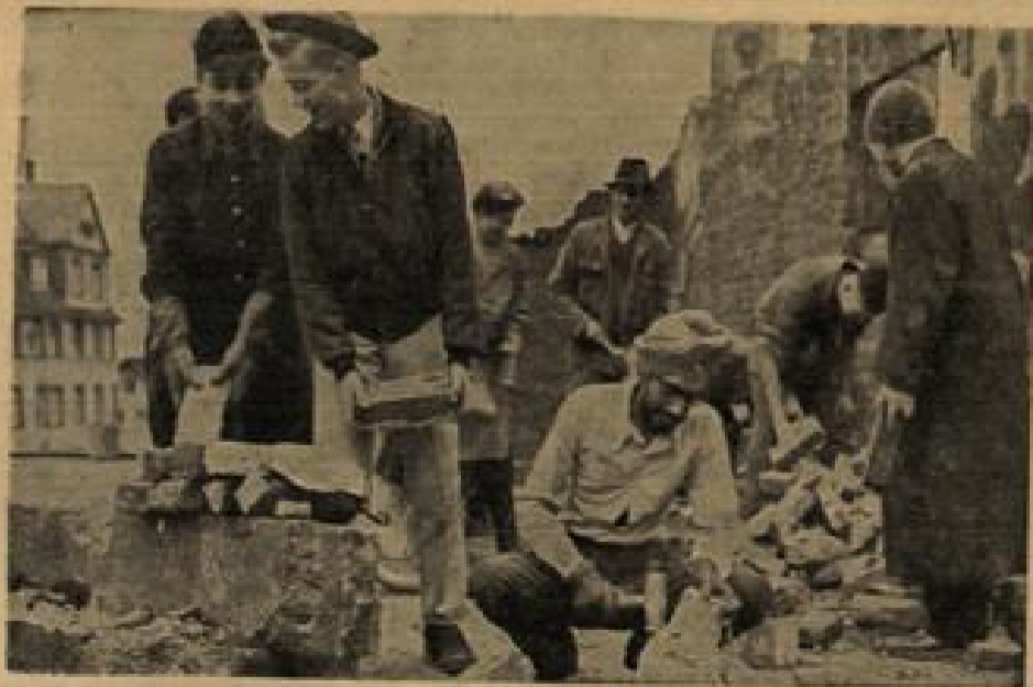
Internationale Bauhilfe für deutsche Flüchtlinge Quäker des Frankfurter Nachbarschaftsheimen helfen deutschen Flüchtlingen beim Aufbau eines zertrümmerten Hauses.
