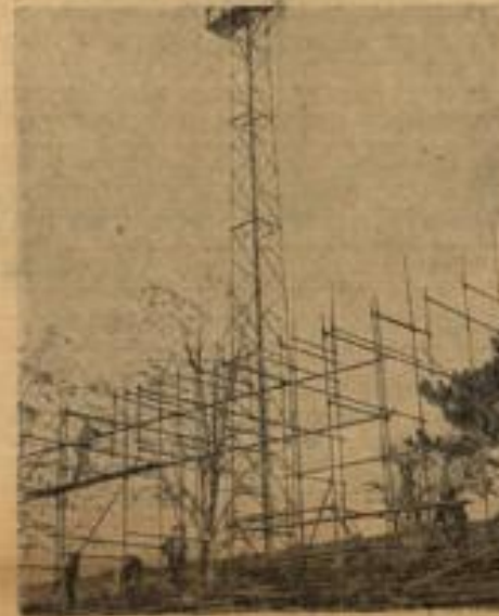
Stahlrohrtribünen für 50 000 werden für das Fußballspiel Schweiz — Deutschland am 15. April in Zürich gebaut
