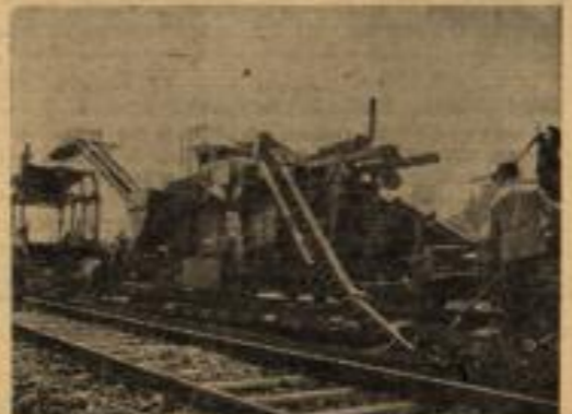
Modernste Maschinen sind bei den Oberbauarbeiten eingesetzt. Bild links: Eine Bettungsreinigungsmaschine säubert den Schotter. — Bild rechts: Ein riesiger Gleishebekran verläßt die Schienen samt Schwellen auf Güterwagen. Fotos (2): Fischer
