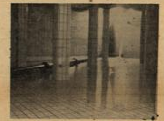
Die linke der beiden großen Wasserkammern im diagonalen Durchblick zu dem hinten sichtbaren Einlauf. Die Leitung auf dem Boden ist die Entnahmelitung, durch die der Hochbehälter auch vom Grundwasserwerk aus gefüllt werden kann. Jede Kammer hat 22,5 m Länge und 17 m Breite. Das größte Fassungsvermögen beträgt 2500 cbm. Foto: Schneider
