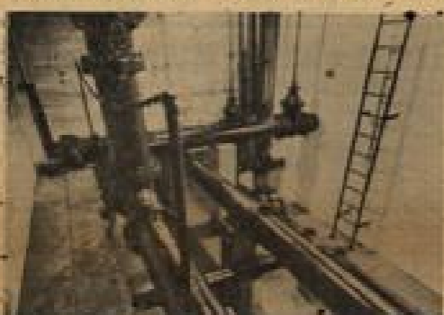
Tellaufnahme aus dem Rohrkeller vor den beiden Wasserkammern. Links die Entnahmelitung mit dem Feuerlöschbogen, der die Brandreserve sicherstellt. Rechts hinten eine der Zuleitungen. Rechts unten die Überlauf- und Leerlaufleitungen. Foto: E. O. Drücke
