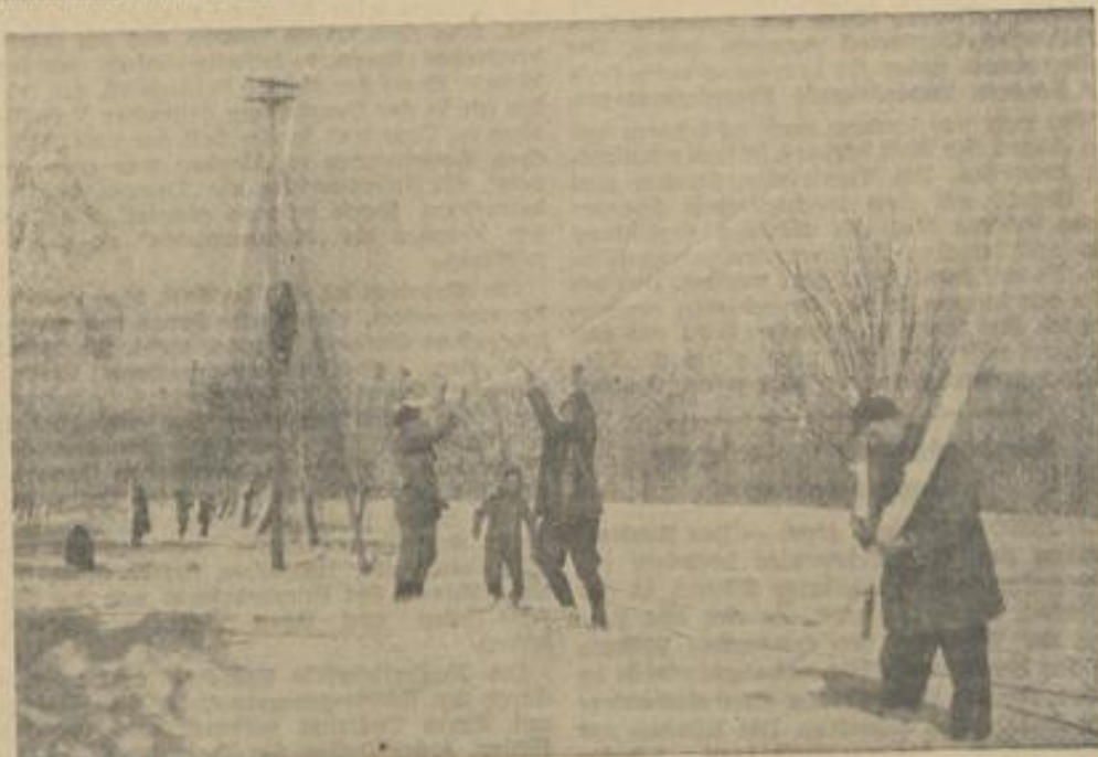
Die Männer mit den Steigeisen sind ständig bereit, gestörte Fernmelde-Anlagen wiederherzustellen. Fotos Pofahl (Bundespost)
