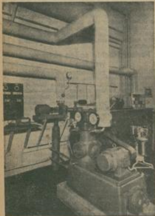
Das Badische Staatstechnikum hat als einzige höhere technische Lehranstalt auch ein kältetechnisches Laboratorium, das mit Hilfe von Stellungen der Industrie eingerichtet werden konnte. Foto: Schmidt
