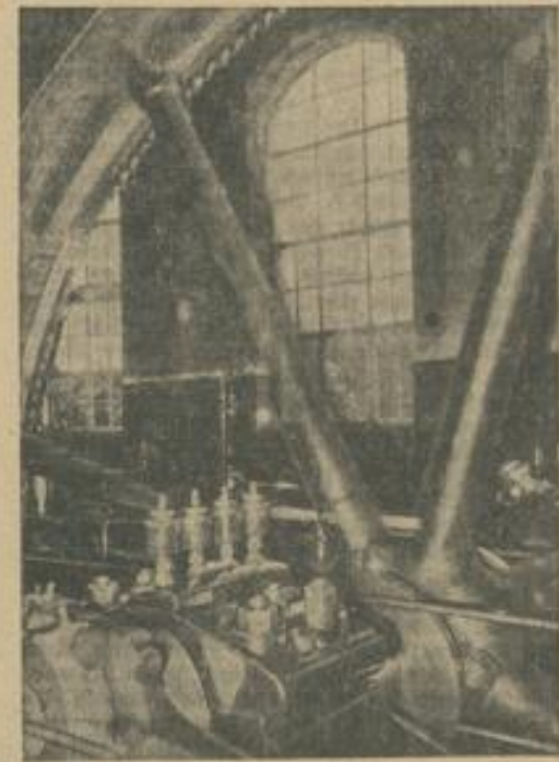
Das Schwungrad der Kältemaschine
