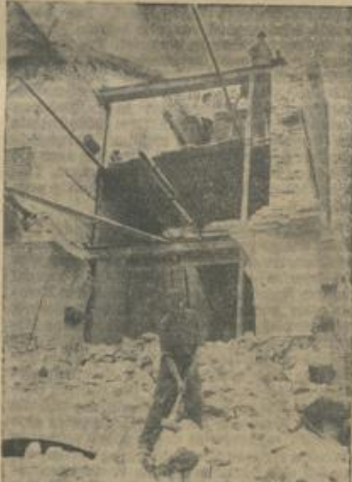
In einem dreiviertel Jahr werden hier wieder Schüler unterrichtet. Arbeiter bei Abrucharbeiten der Schillerschule. Fotos: Weiß
