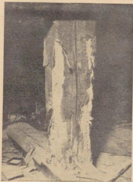
Von Hausbocklarven zerstörter Tragbalken. Der Schaden wurde erst offensichtlich, als man die unversehrte papierdünne Oberschicht mit einem Messer abhob.
