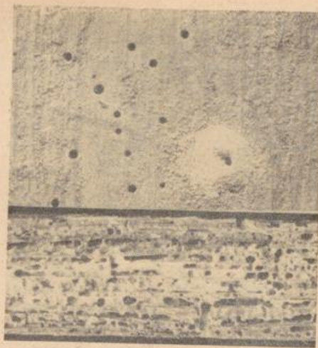
Ausbohrlöcher der Pochkäfer in Kiefern Brett und Bohrmehlhäufchen. Das Innere der Bretter ist durch die Fraßgänge der Larven vermulmt.
