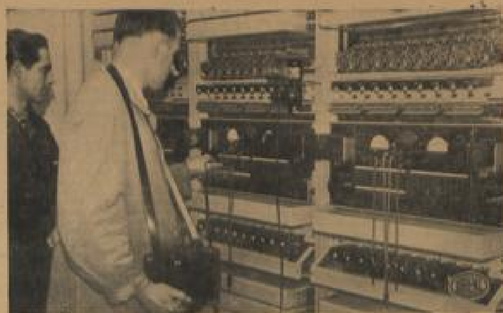
Letzte Prüfung der Wähler-Gestelle vor der Einschaltung des TW-Amtes Ulm
