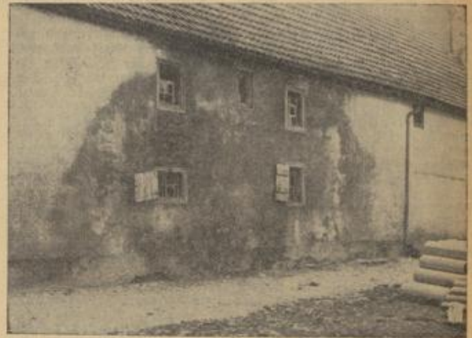
Auswirkung nicht isolierter Wände.
