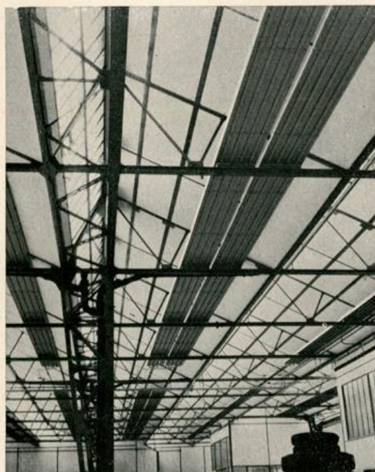
Stahlplattenheizung Michelin Reifenwerke, Karlsruhe
